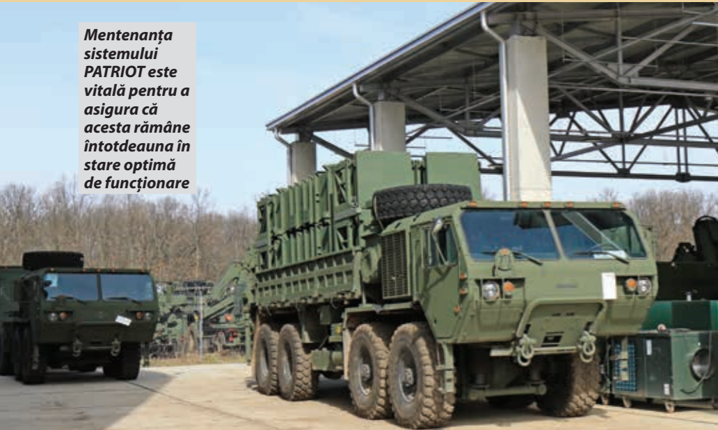
Mentenanță la una dintre unitățile de alimentare cu energie electrică a sistemului PATRIOT
